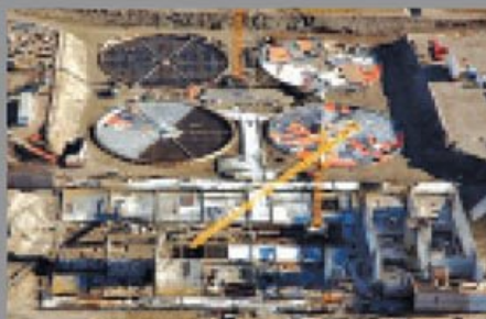
Pine Creek WWTP, Kanada
