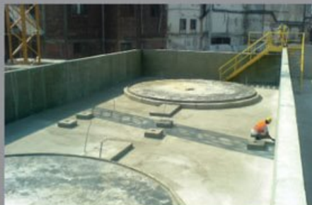
Meroko WWTP, Slovačka
