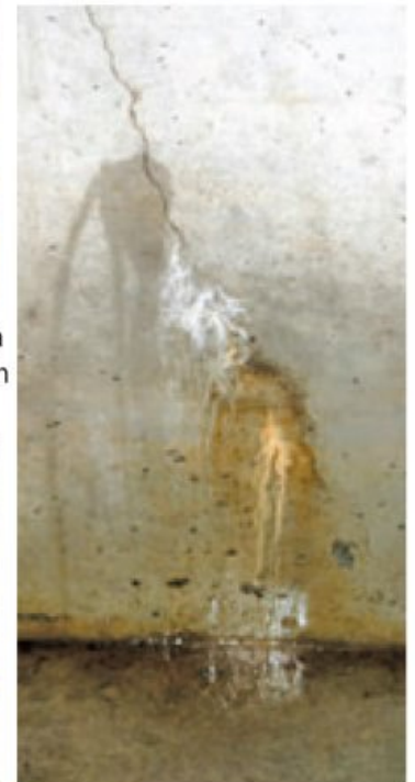
Prodor kroz pukotine / građevinske spojeve
